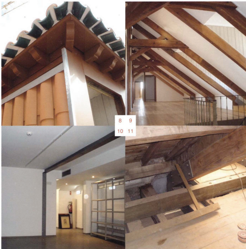
8 | Casa dos Patudos Aspetto interior da estrutura das coberturas, em madeira, antes da intervenção
